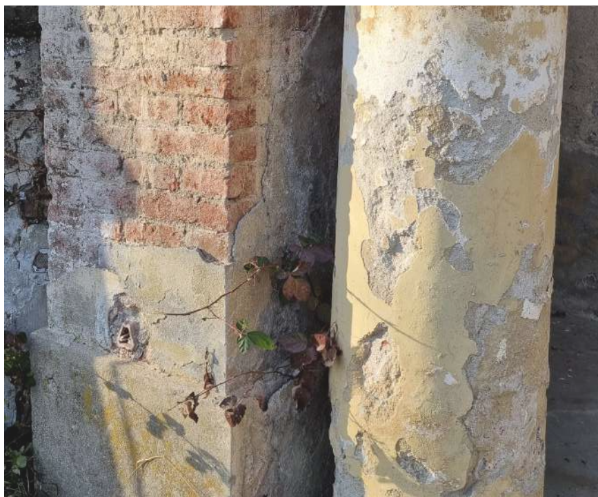
Figura 172 Fenomeno del distacco. Fonte: archivio personale Sopralluogo 07/06/2022.
