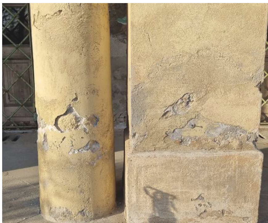
Figura 173 Fenomeno della lacuna di intonaco. Fonte: archivio personale Sopralluogo 22/12/2022.
