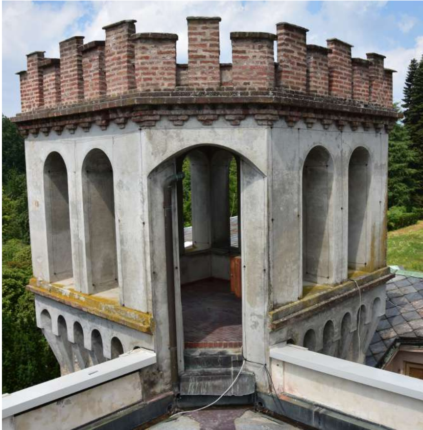
Figura 153 Torre quadrata con loggia aperta su tutti i lati. Fonte: archivio personale Sopralluogo 07/06/2022.
