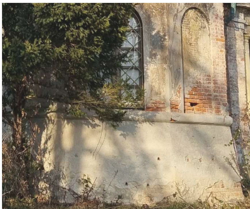
Figura 171 Fenomeno del deposito superficiale. Fonte: archivio personale Sopralluogo 07/06/2022.
