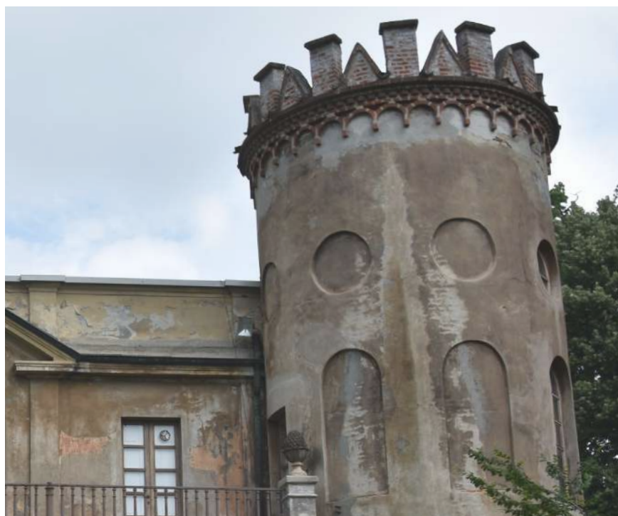
Figura 162 Fenomeno del dilavamento della tinteggiatura. Fonte: archivio personale Sopralluogo 07/06/2022.
