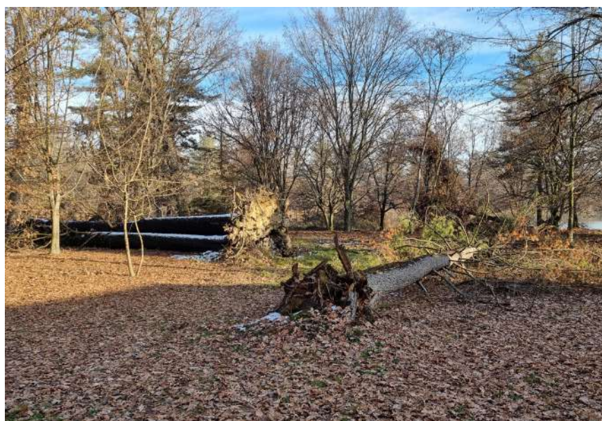
Figura 117 Caduta delle alberature a causa dei fenomeni atmosferici. Fonte: archivio personale sopralluogo 22/12/2022.
