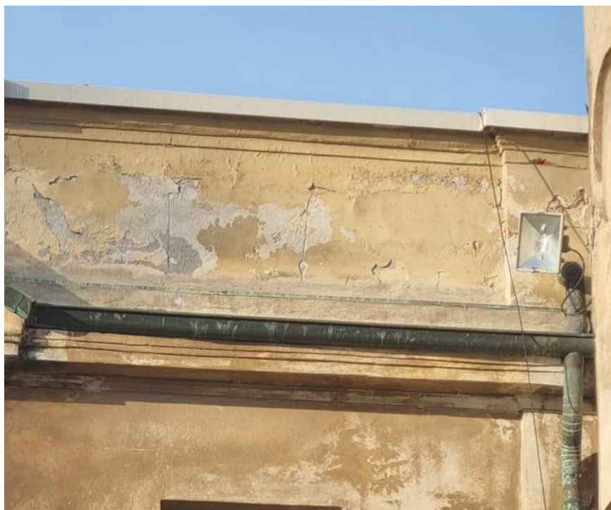
Figura 166 Fenomeno dell'esfoliazione. Fonte: archivio personale Sopralluogo 07/06/2022.
