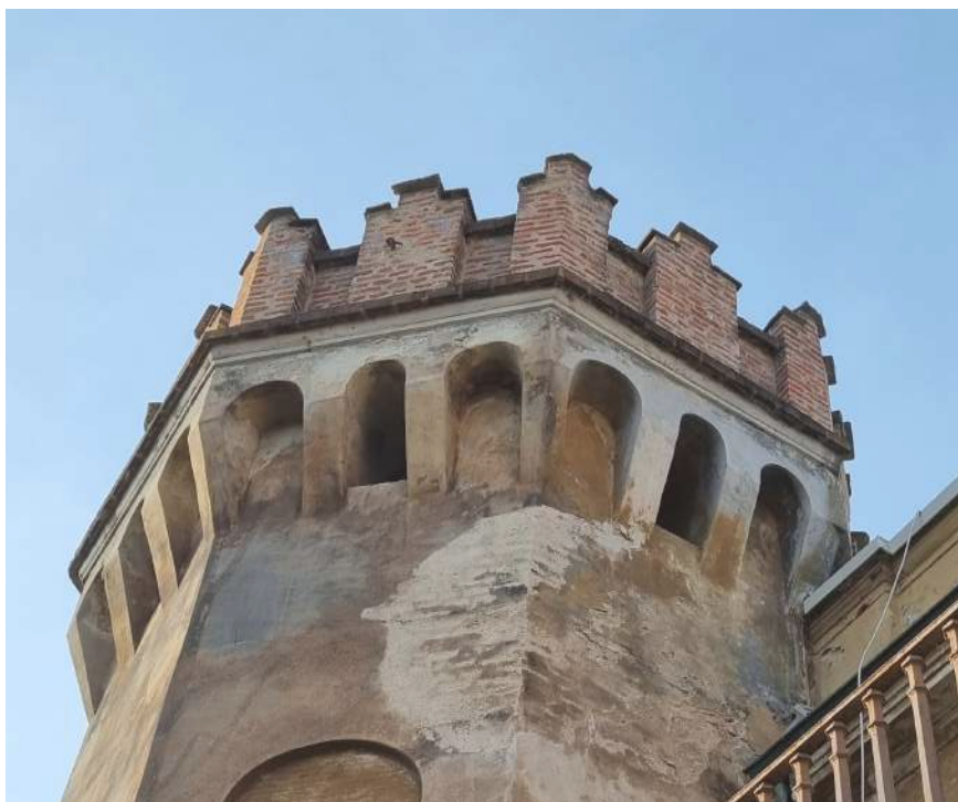
Figura 165 Fenomeno dell'efflorescenza salina Fonte: archivio personale Sopralluogo 07/06/2022.
