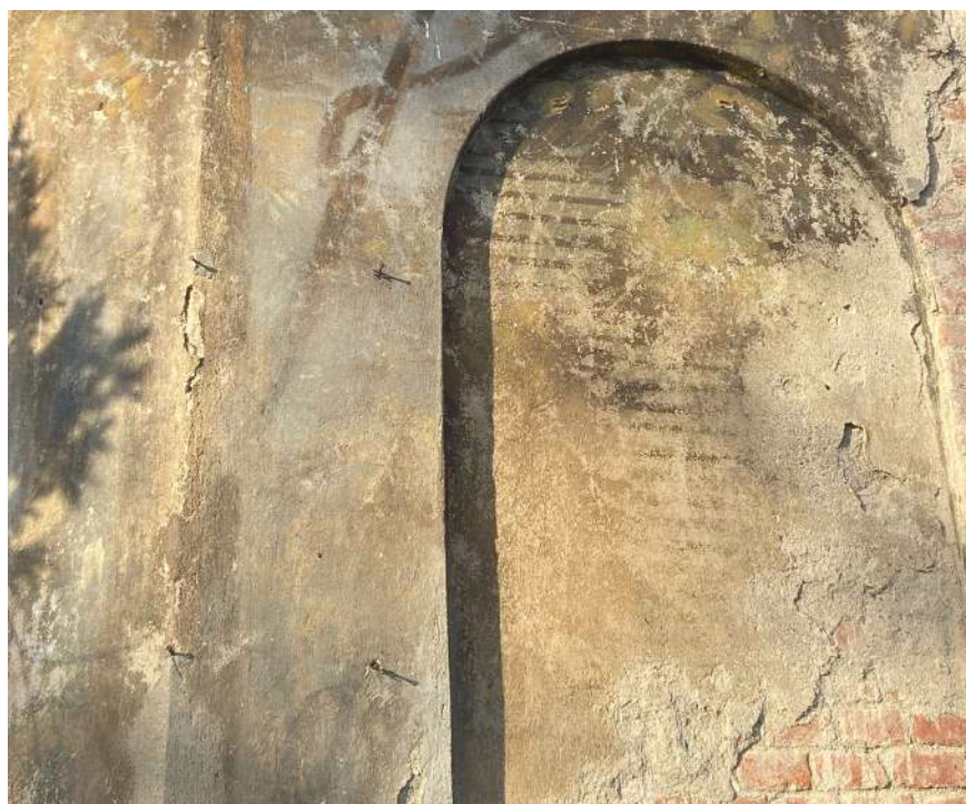
Figura 164 Fenomeno dell'erosione superficiale dell'intonaco. Fonte: archivio personale Sopralluogo 07/06/2022.
