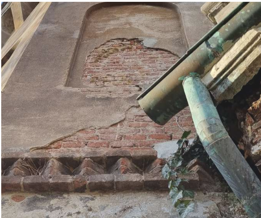
Figura 167 Fenomeno della corrosione. Fonte: archivio personale Sopralluogo 07/06/2022.
